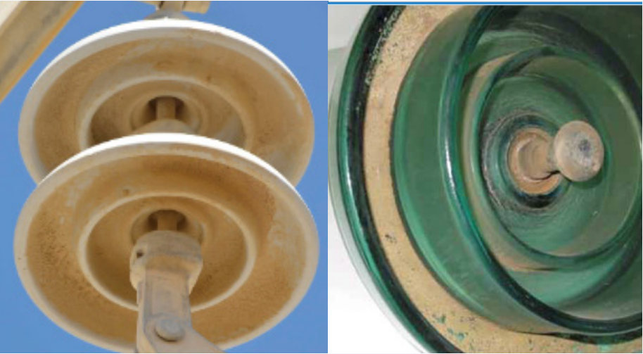
Isoladores de suspensão tipo discos com acúmulo de poluentes nas nervuras inferiores
